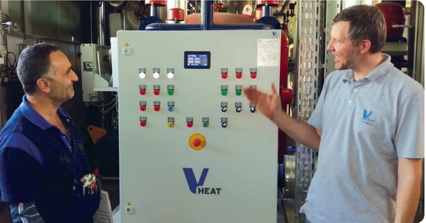
↑ Inbetriebnahme der ersten Generation RS4 im hochsensiblen Bereich einer Heißwasseranlage im Krankenhaus
